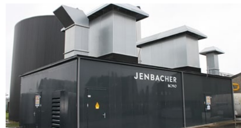
Modulare Gewächshauslösung: Jenbacher Kraft-Wärme-Kopplungs- system mit Schalldämmhaube
