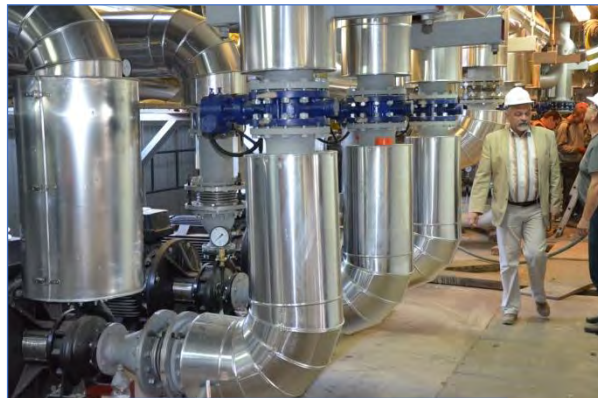
Próby w pompowni
